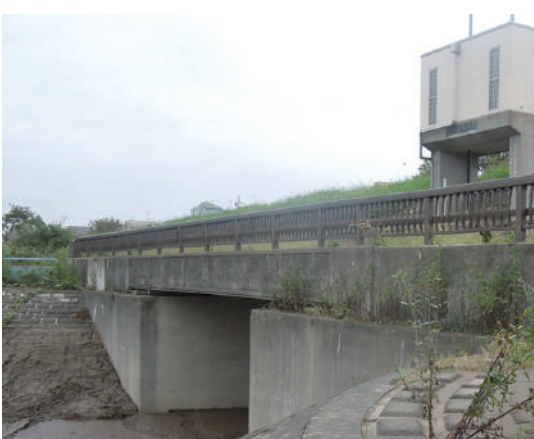
猪方排水樋管（駒井町3丁目）。水道道路以南の雨水を集めて多摩川に放流している。多摩川が増水し雨水と多摩川の水が住宅地に流れ込んだ。市は排水門を開けたまま監視活動を行っていたが多摩川の水位が上がり12日午後7時半退避した。
