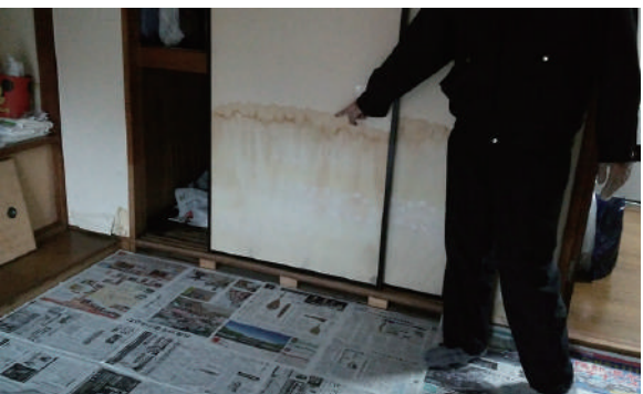
駒井町・床上浸水。畳や衣類の入ったタンスなど家財道具が水浸しになり家の外に運び出した。
