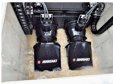
兵庫県丹波篠山市の排水ポンプ場（写真上）と排水ポンプ（写真下）。160m 2 の敷地に工事費約3億円（国庫補助1／2あり）で建設。
