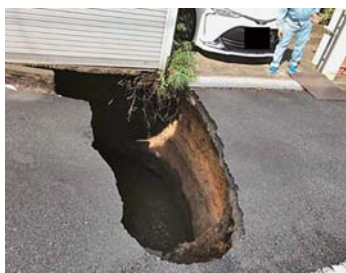
調布市の道路陥没現場
